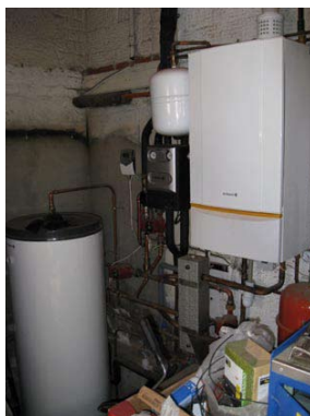
Chaudière et chauffe-eau
